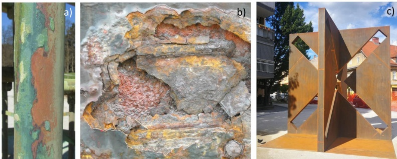
Slika 2: Primeri različnih kompleksnih oksidiranih površin: a) patina in korozijski produkti na bakreni cevi, b) prerjavenje železa zaradi tvorbe oksidnih produktov, c) stabilni oksidni sloj na kortenu
